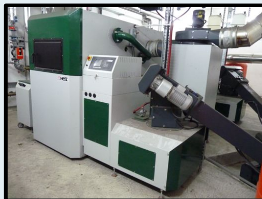
Chaudière dans local technique
