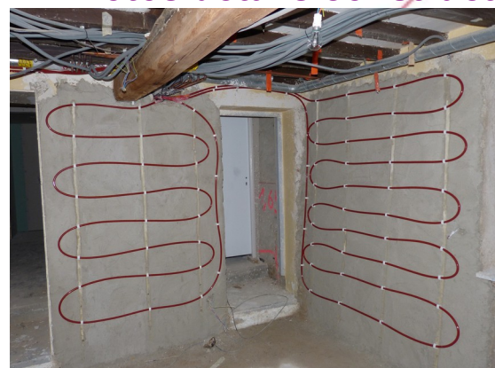
Serpentins du mur chauffant
