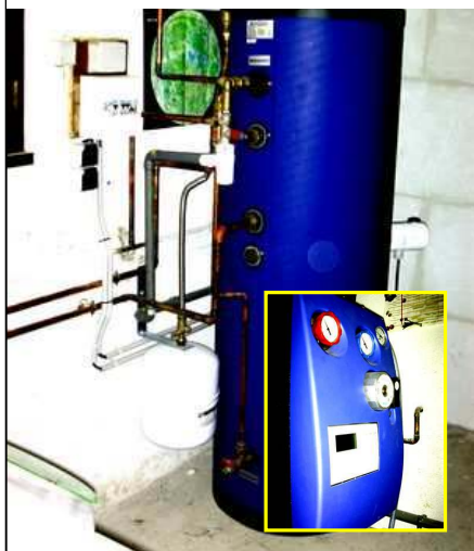
Ballon solaire de 300 litres avec appoint biénergie
